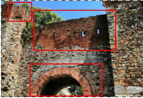
Figure.12. Reconstruction de la partie démolie un du mur de l'arc avec un nouveau type de pierre taillée.
