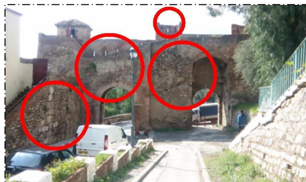
Figure.11 : Dégradation du mur d'une façon hétérogène/ Source : par l'auteur
