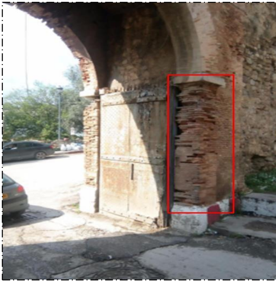
Figure.14. Dégradation du mur
