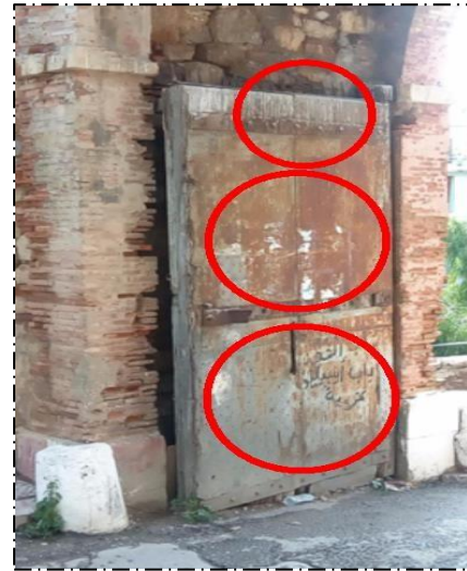
Figure.9 : porte dans un état de dégradation source : par l'auteur
