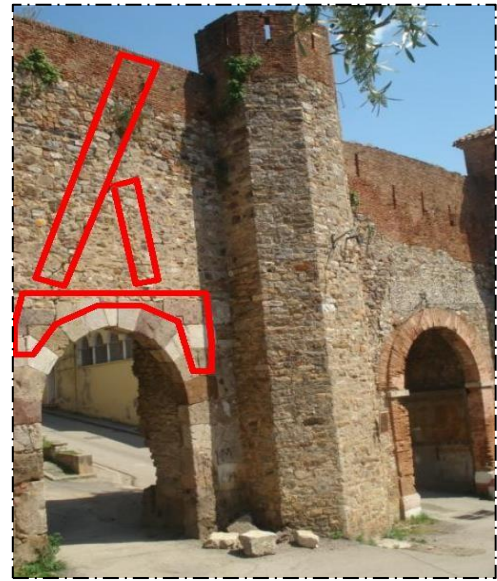
Figure.15. Fissure oblique et d'autre fissure importante
