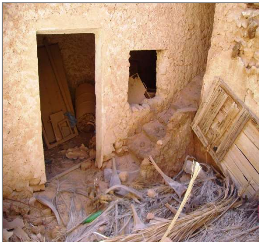
Photo 16 : Un patrimoine en ruine ( maison ksourienne) .
