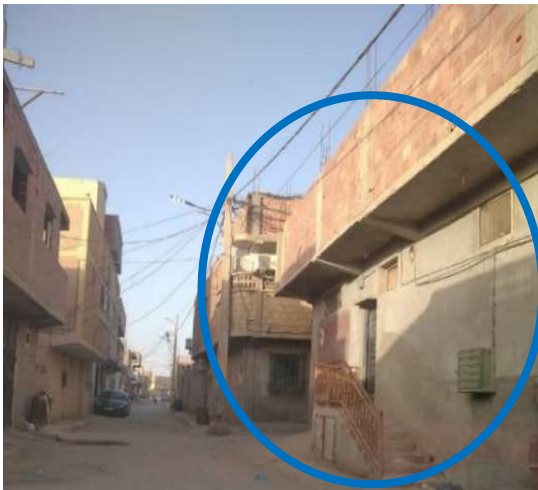
Photo 15: Dépassement au détriment de l'alignement des construction et extension horizontale
