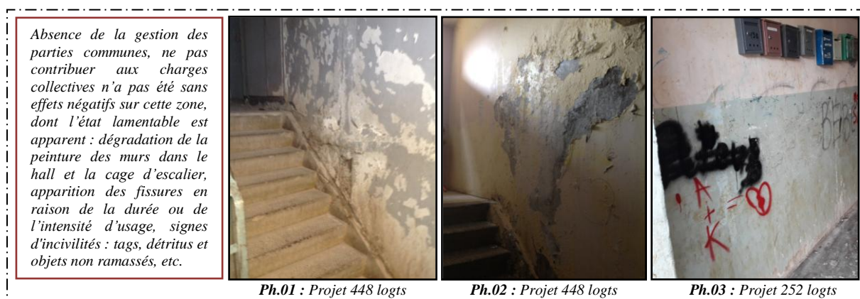
Figure 161 : État de dégradation des murs dans les parties communes des blocs d'habitations
