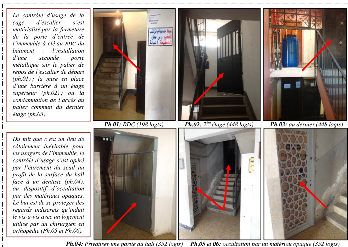
Figure 156 : Dispositifs de protection pour récupérer le contrôle du seuil et l'usage de la cage d'escalier
